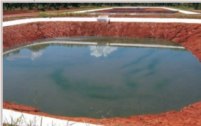
Sistema de coleta e tratamento de esgoto já funciona em Nova Pinheirópolis
