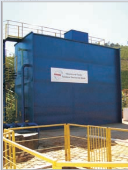
Estação de tratamento de esgoto para os municípios
